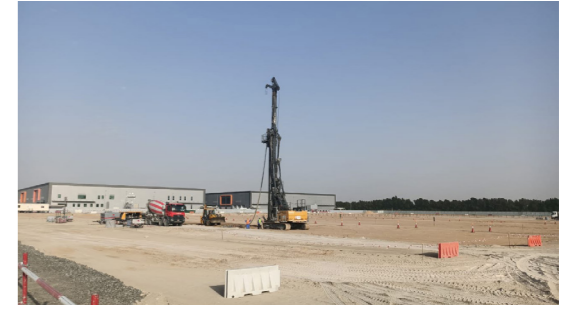
Khazna Data Center (UAE)
