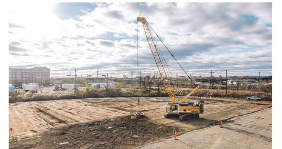
Flat Rock Data Center (USA)
